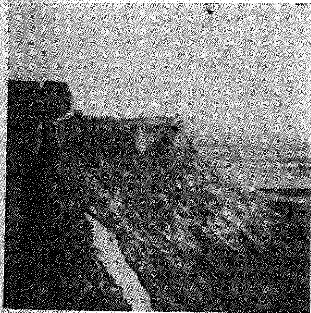
图五 韩城县东少梁原上魏西长城东端黄河冲塌部分
